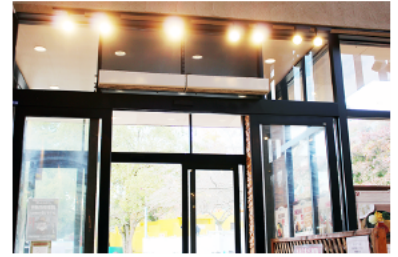
定期的な施設内換気の実施
